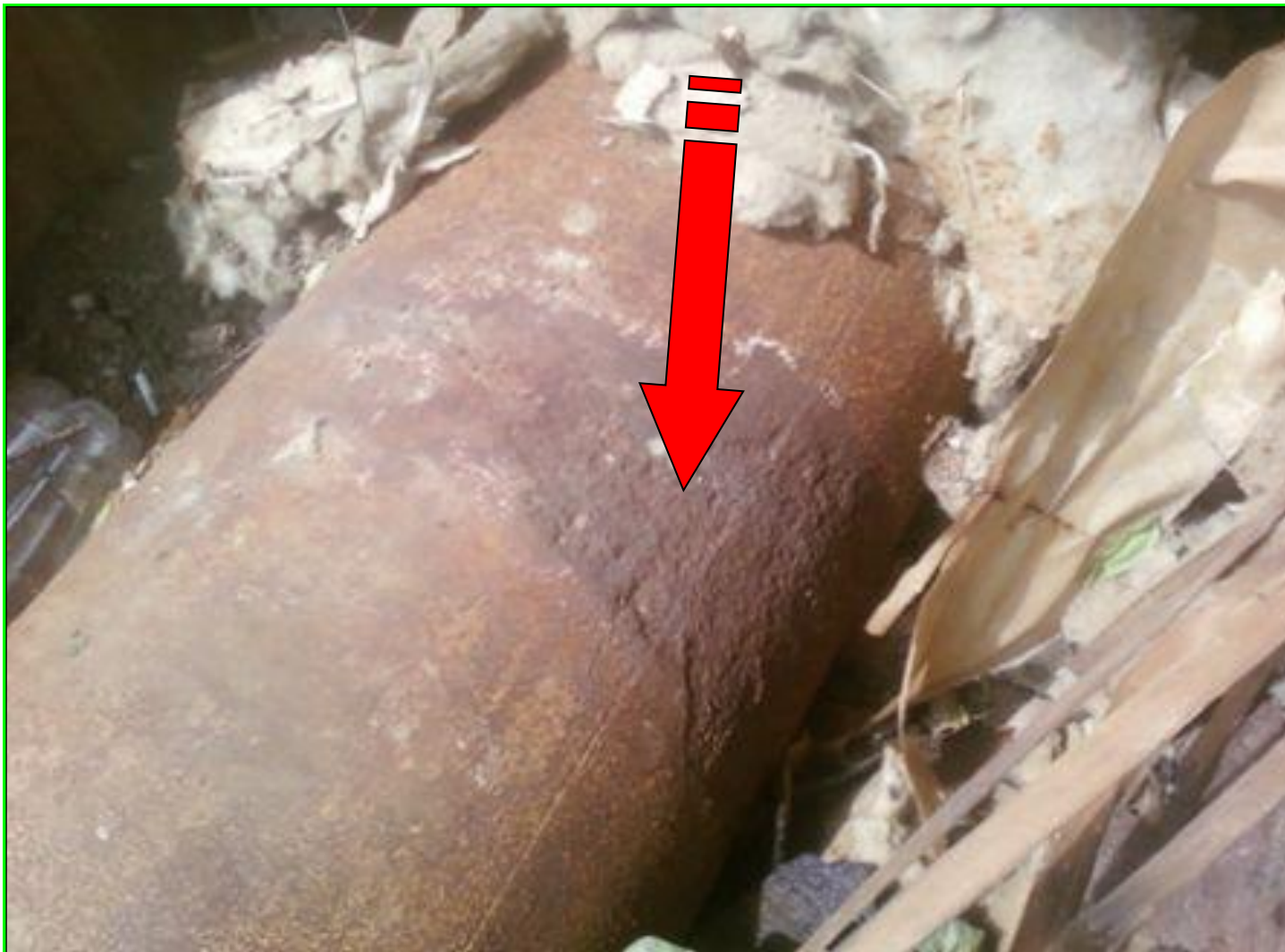
Фото 3. Фактическое состояние трубопровода по выявлению диагностики
