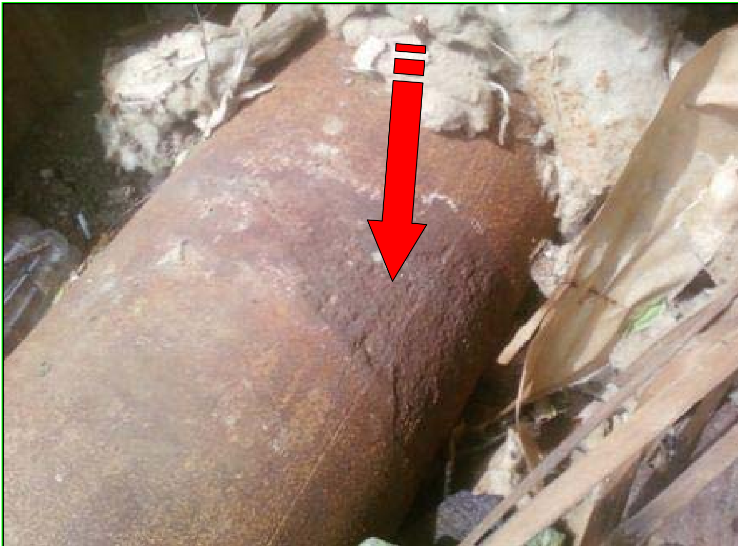
Фото 3. Фактическое состояние трубопровода по выявлению диагностики
