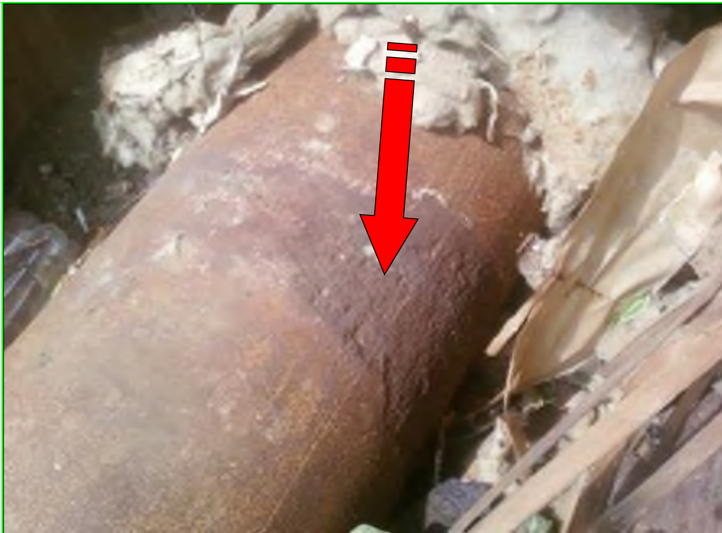
Фото 3. Фактическое состояние трубопровода по выявлению диагностики
