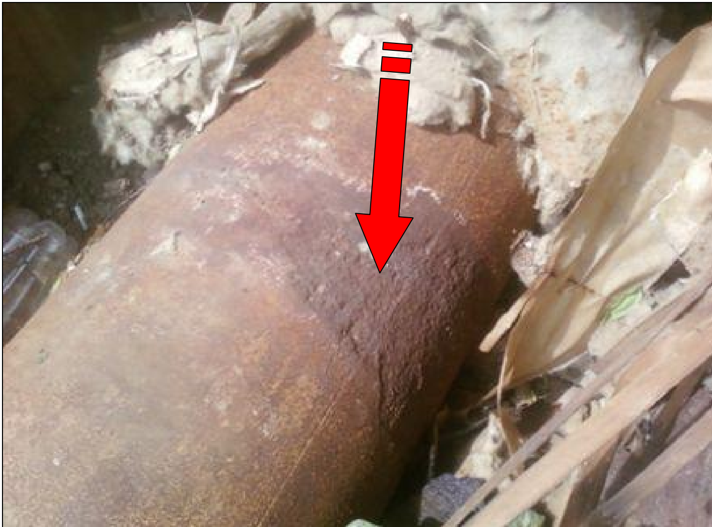
Фото 3. Фактическое состояние трубопровода по выявлению диагностики
