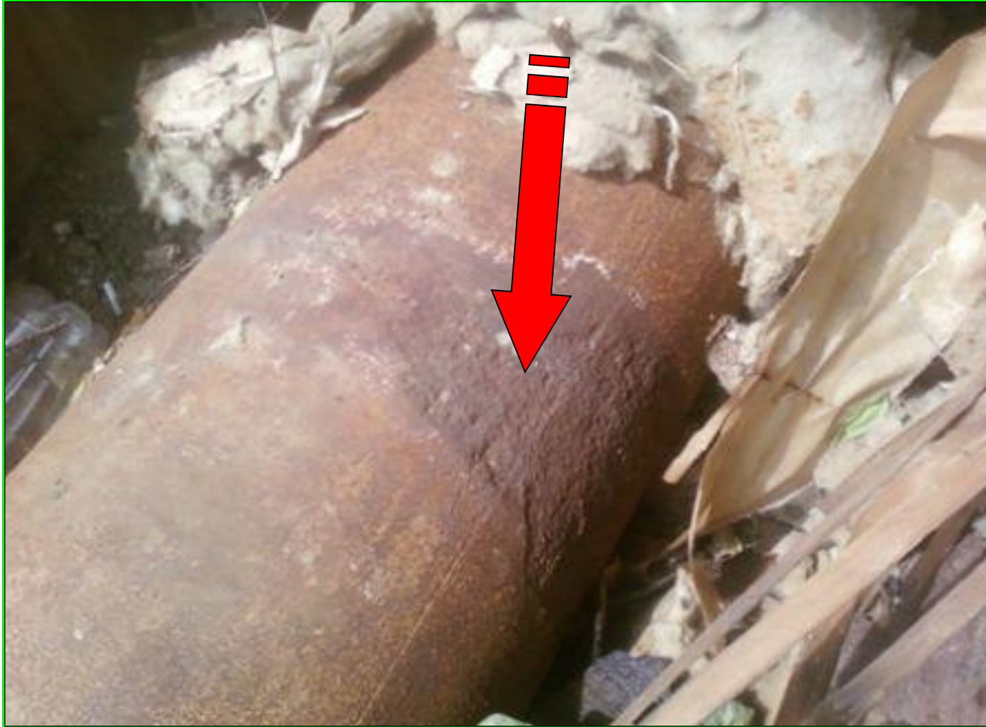
Фото 3. Фактическое состояние трубопровода по выявлению диагностики
