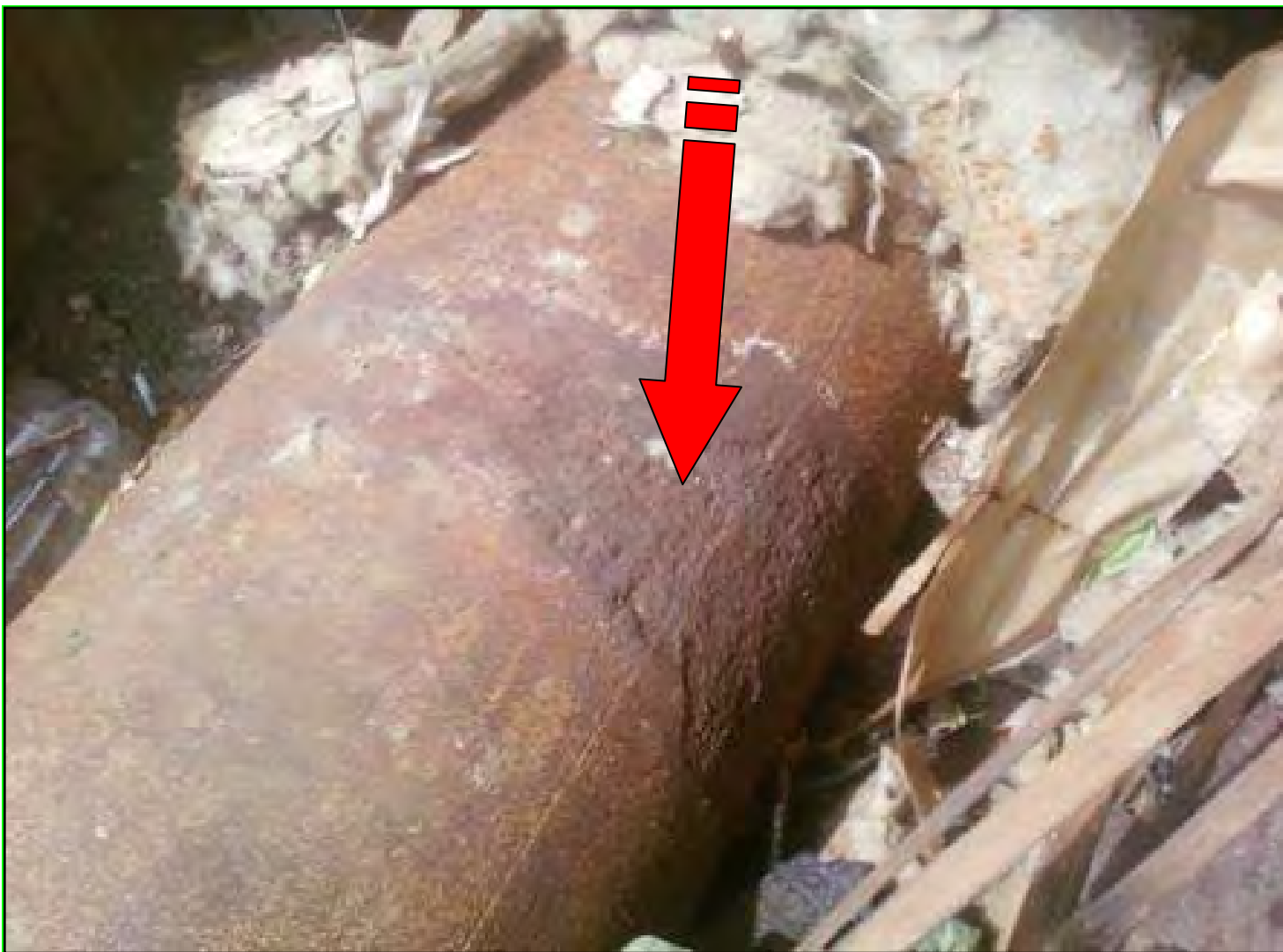
Фото 3. Фактическое состояние трубопровода по выявлению диагностики
