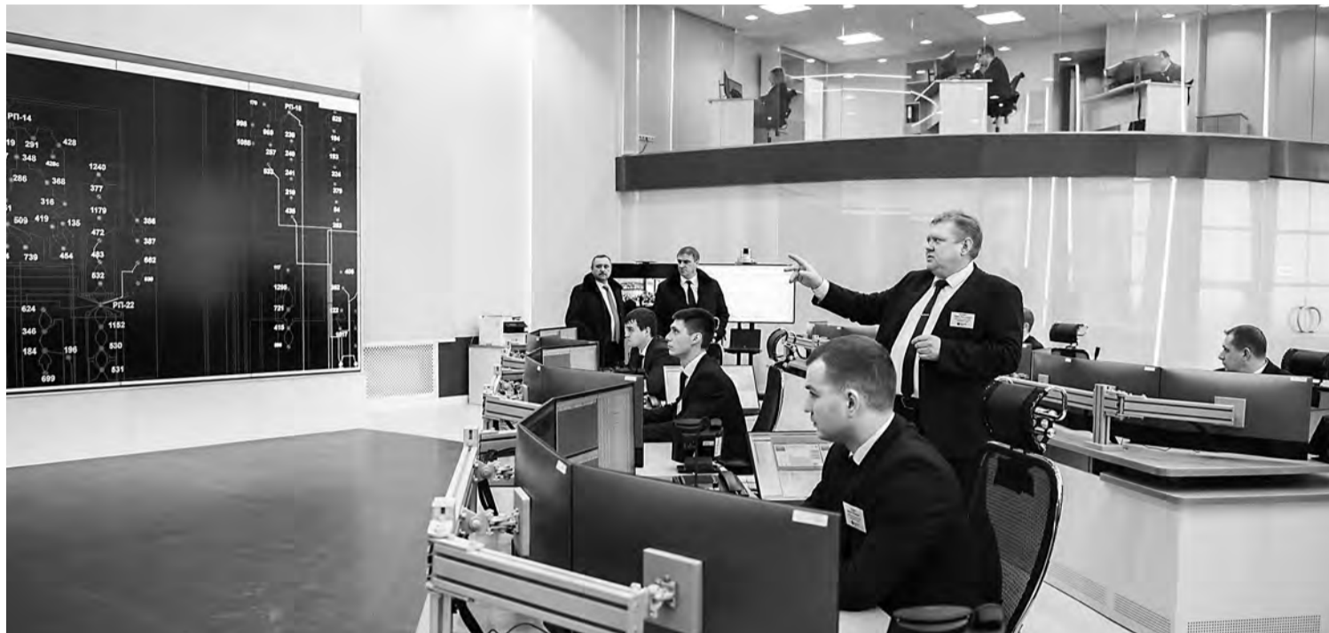
Диспетчеры во главе с начальником участка оперативно-технического управления Павлом Пашиным обеспечивают управление сетевым комплексом Белгорода и Белгородского района.
