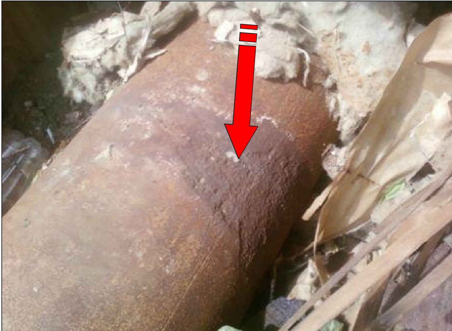
Фото 3. Фактическое состояние трубопровода по выявлению диагностики
