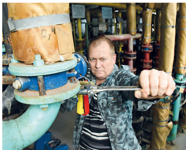
Оператор котельной за работой.
