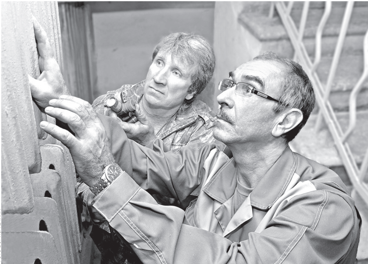
Слесари Александр Нечухрин и Виктор Панов из УК №7 города Белгорода проверяют работоспособность отопительной системы дома по Свято-Троицкому бульвару, 5.
