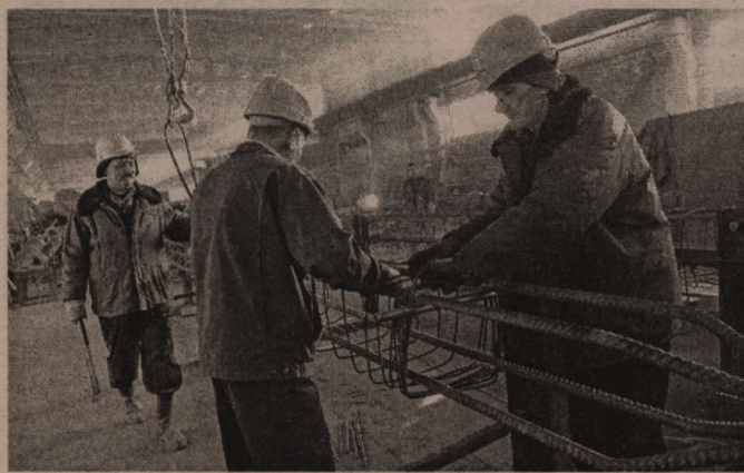
Формовщик Геннадий Кравченко, арматурщик Сергей Титов, сварщик Алексей Исычко ведут подготовку свай
